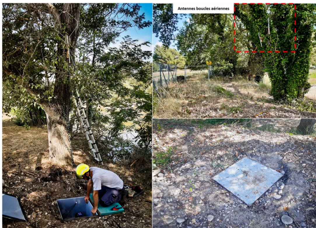
Figure 12 : Une station aérienne implantée dans le milieu naturel. Les dispositifs électroniques ont été enterrés par discrétion. L'antenne était alors peu visible après l'installation.
