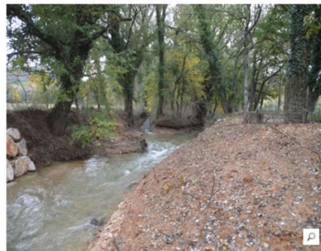
Le Malaurie après arasement des 4 ouvrages transversaux entravant la continuité écologique du cours d'eau
