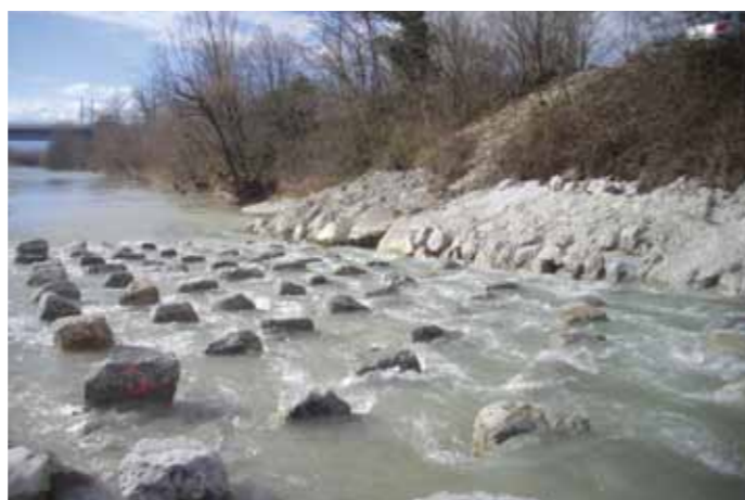
La rampe à macro-rugosité installée en 2013 sur le seuil dit du SMARD à Crest : une solution technique bien adaptée aux rivières à fort débit sédimentaire comme la rivière Drôme.
