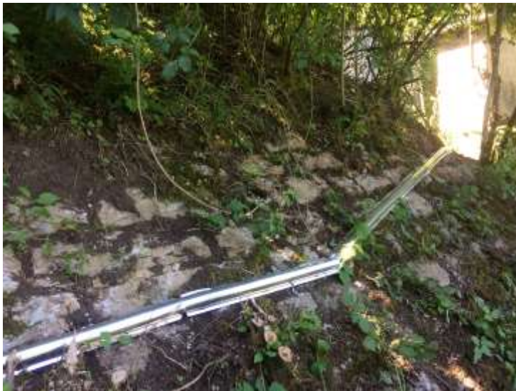
Cheminement du câble entre le capteur et le modem
