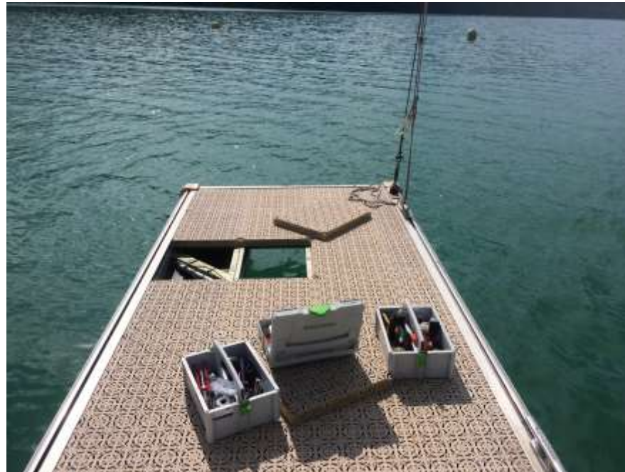
Implantation d'un piézomètre + modem – Retenue de Vouglans
