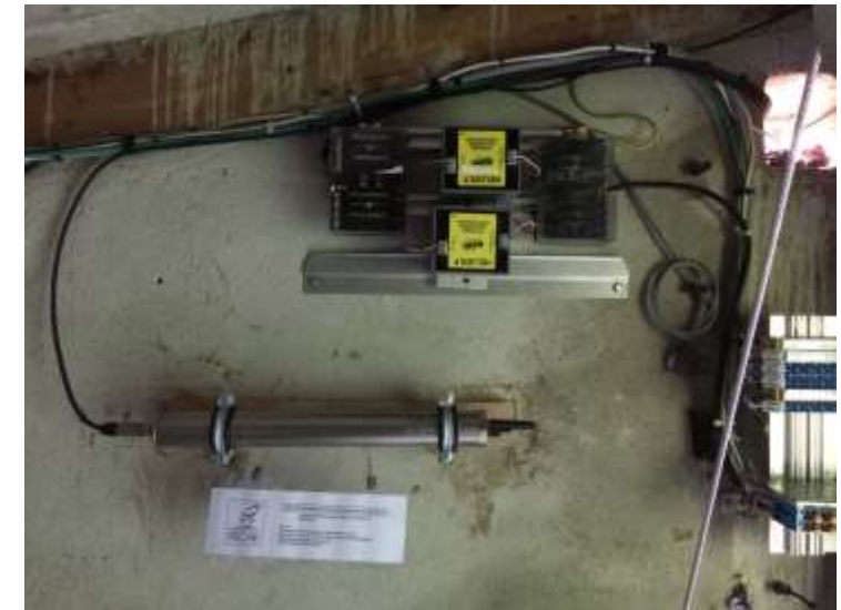
Modem installé dans un abri hydrométrique
